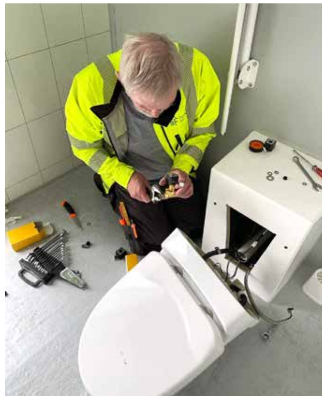
Jan Petter Lied i ferd med å reparere eitt av toaletta som har fått skade.
