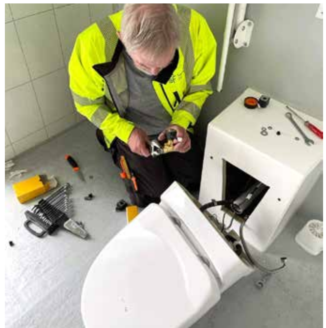
Jan Petter Lied i ferd med å reparere eitt av toaletta som har fått skade.
